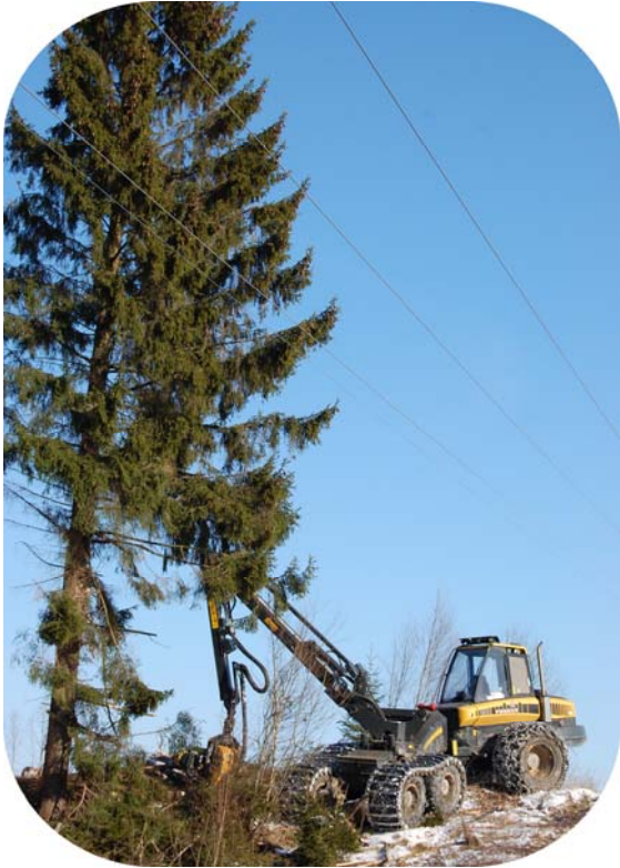
Sikringshogst av utsatt grantre, regionalnett
